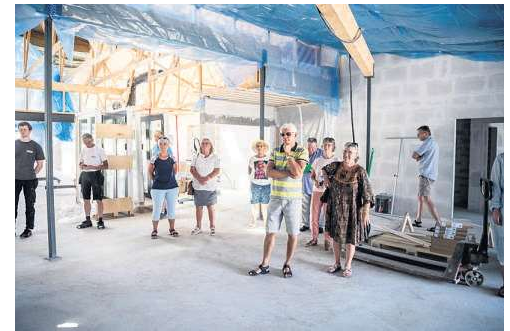
Løgstrup Fripleshjem får to lejlighedsfløje, der mødes omkring et stort fællesareal med blandt andet køkkener og opholdsstue. Foto: Morten Pedersen
